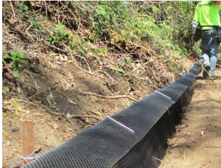
Figura nr. 5-9 Exemplu al unui gard permanent pentru amfibieni și reptile (Sursa: ERTEC Environmental Systems)
