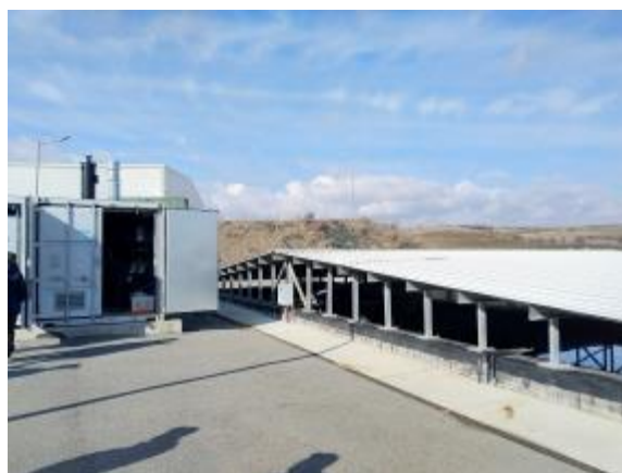
Stația de epurare levigat
