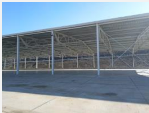
Stația TMB – zona de maturare
