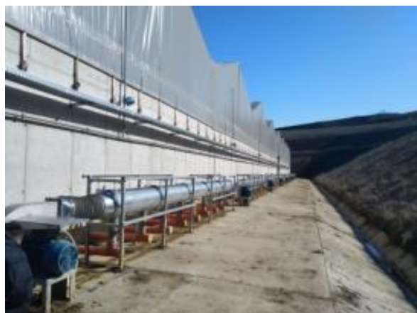
Stația TMB – sistem aerare
