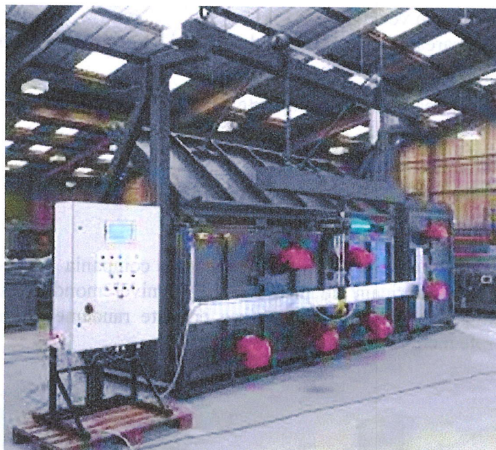
Figură 2: vedere incinerator din spate (zona arzătoarelor)
