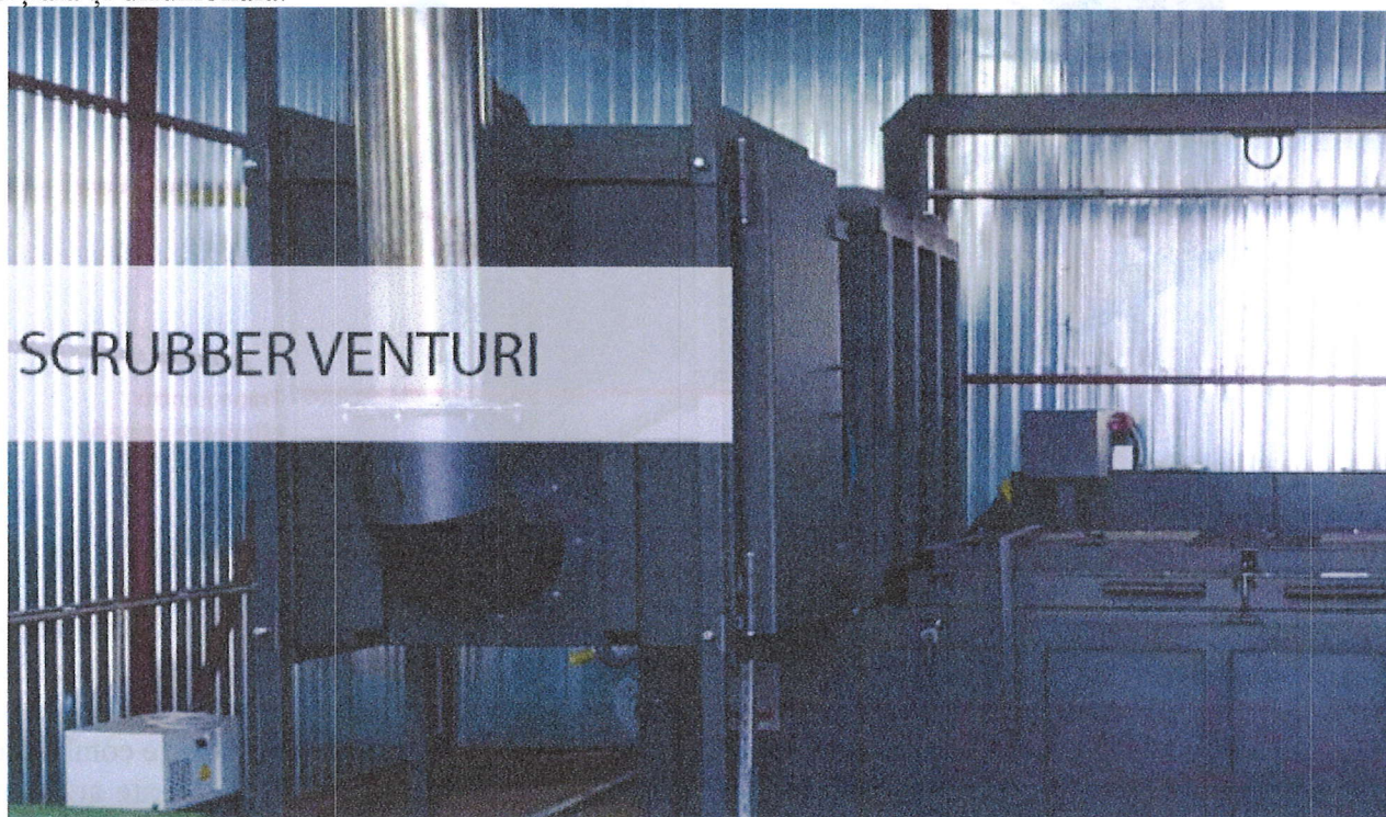
Figură 6: vedere spălător Venturi
