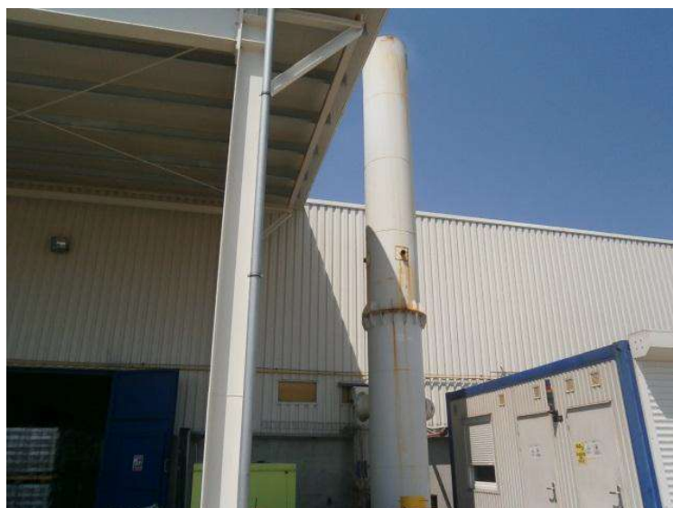
Fig. 6 Coș pentru evacuarea noxelor exhaustate
