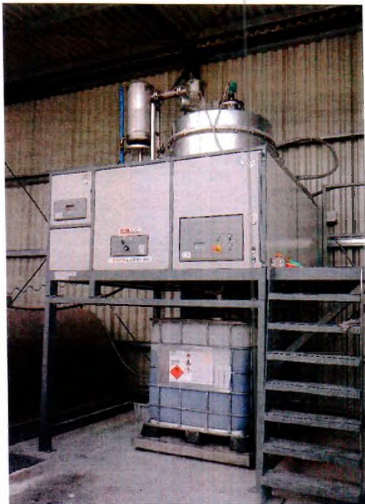
Foto 7 – Instalatie distilare solventi HR600
