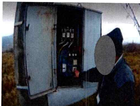
Înterupere alimentare cu energie electrica
