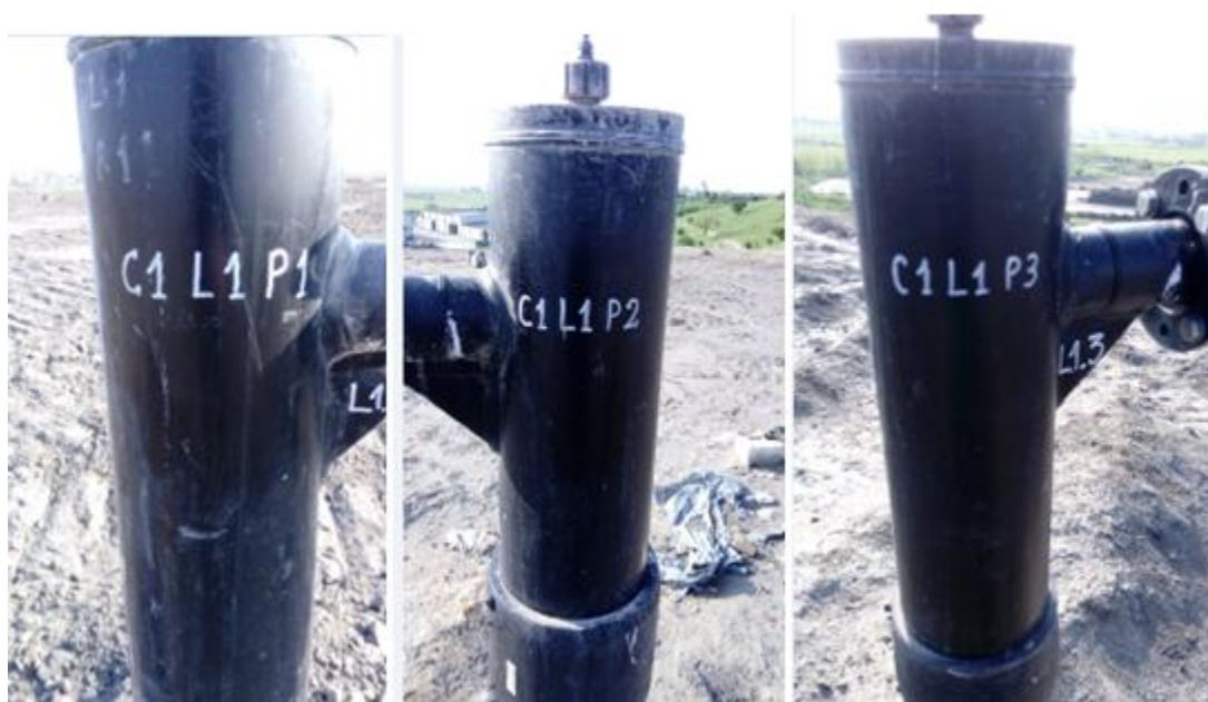
Foto 6: Sistemul de degazare a gazului de depozit pe celula nr. 1
