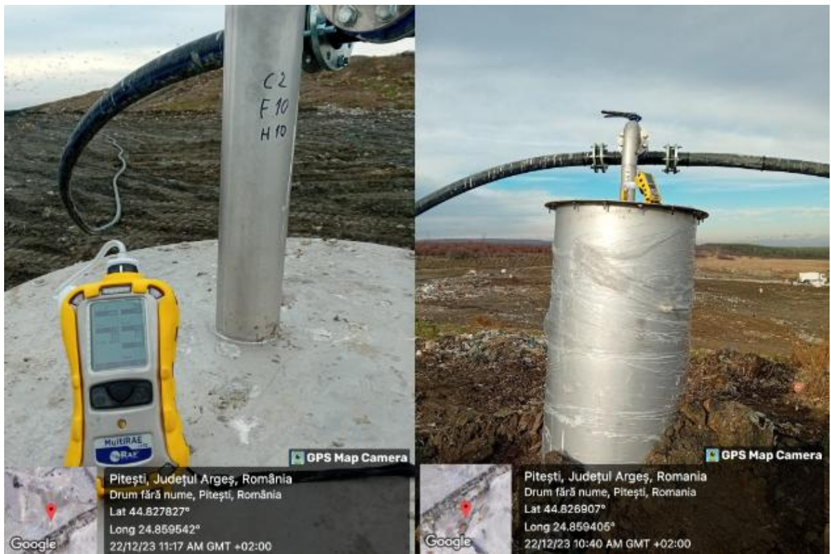
Foto 7: Sistemul de degazare a gazului de depozit pe celula nr. 2
