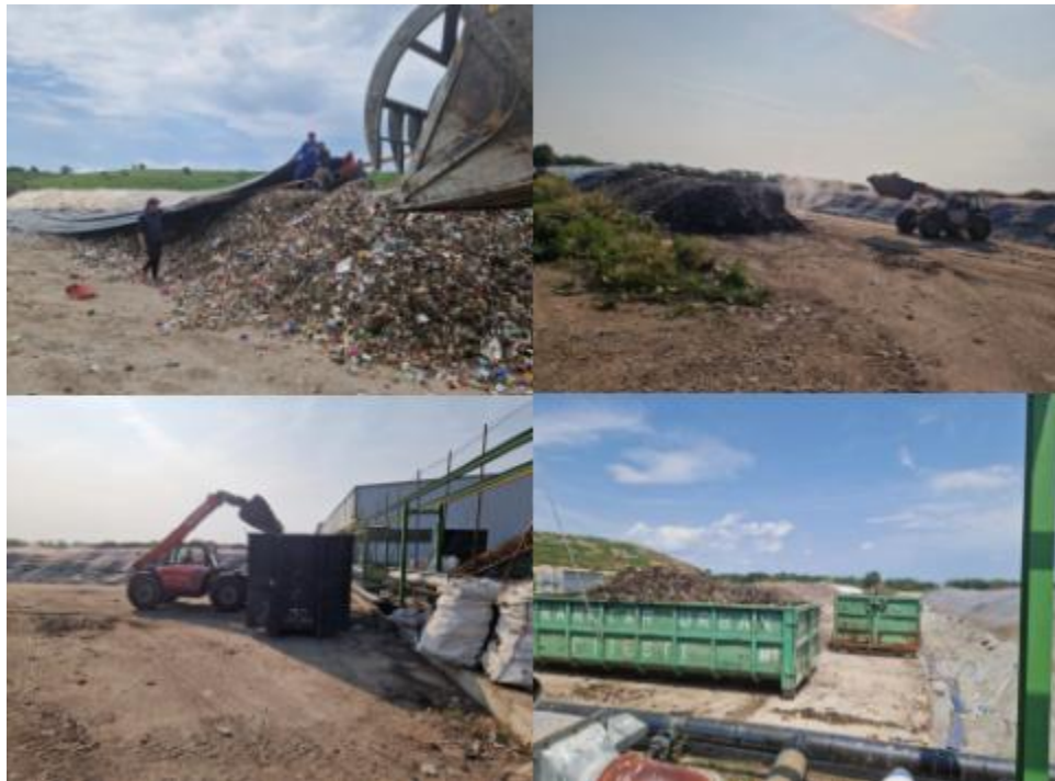
Foto 12: Zona de tratare biologica – platforma CLO – etape proces
