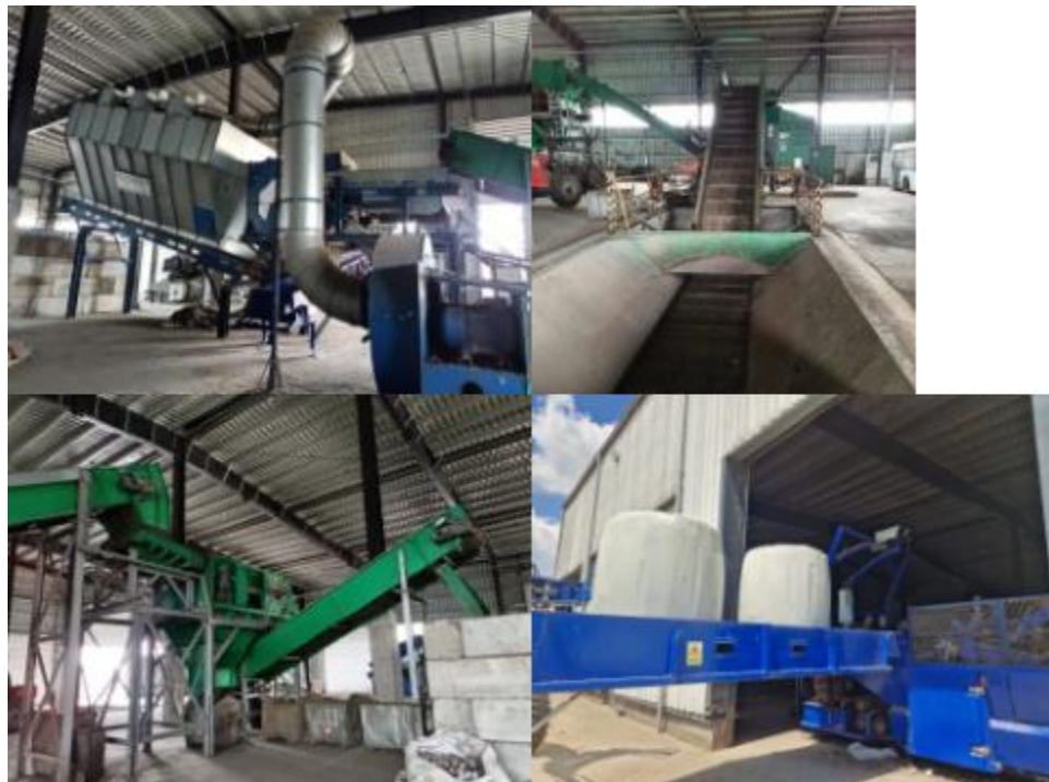
Foto 1: Instalatia de tratare mecanica – vedere interioara
