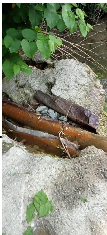
Conductă total expusă cu cămășuiala ruptă
