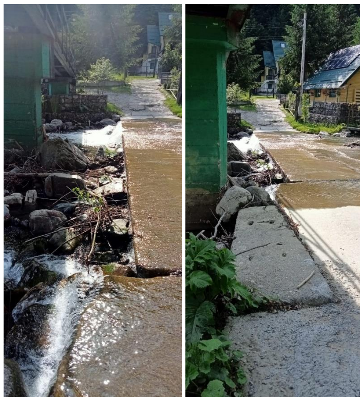
Foto 2. Vedere prag generat de o traversare a albiei râului (P2)
