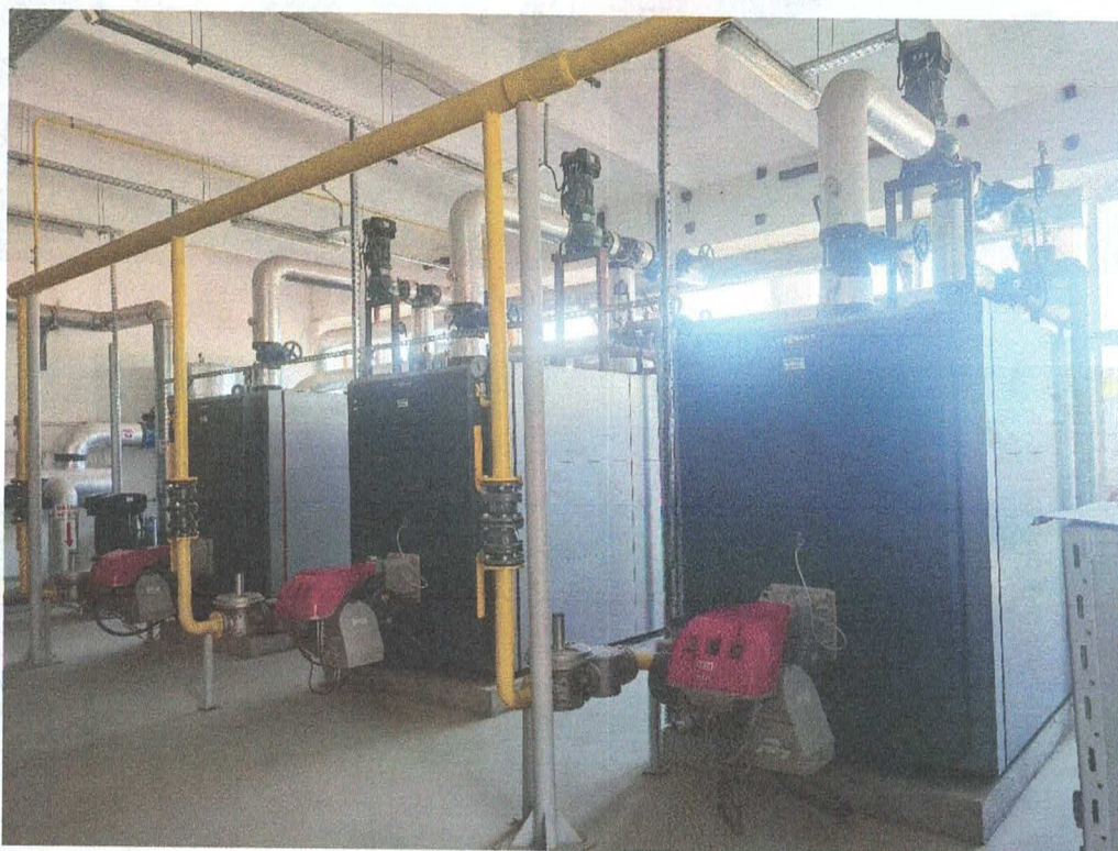
Figura nr. 8. Centrala termică cu trei cazane VISSMANN VITOPLEX 200
