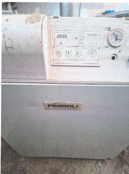
Figura nr. 10. Centrala termică FERROLI cu P=100\text{ kW} (pentru încălzirea cantinei)
