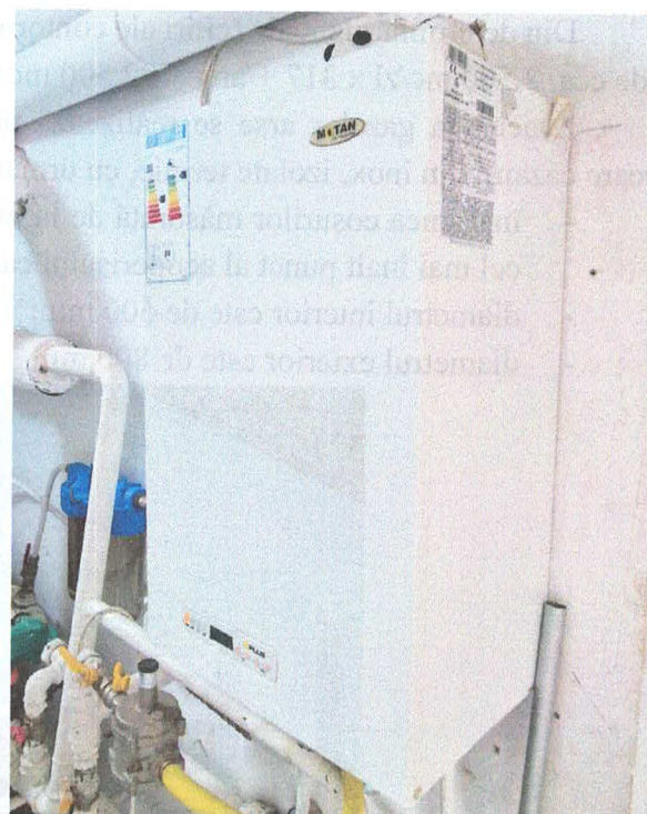
Figura nr. 11. Centrala termică murală MOTAN cu P=24\text{ kW} (pentru asigurarea apei calde la cantină)
