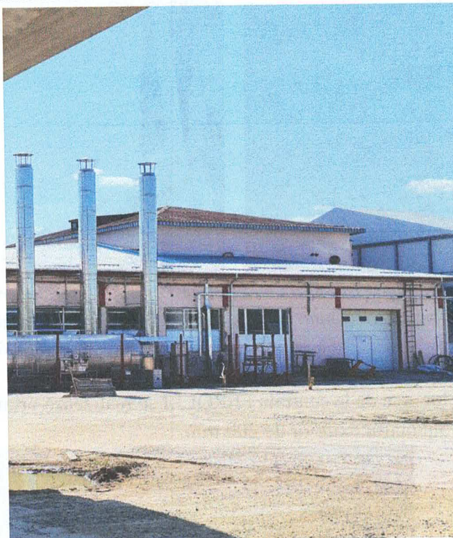
Figura nr. 9. Coșuri de disperise centrala termică
