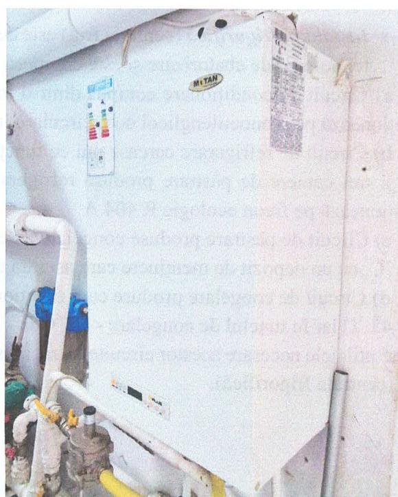
Figura nr. 11. Centrala termică murală MOTAN cu P= 24 kW (pentru asigurarea apei calde la cantină)
