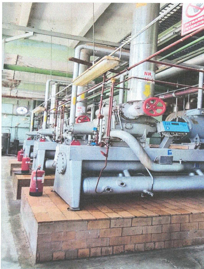
Figura nr. 13. Centrala frig
