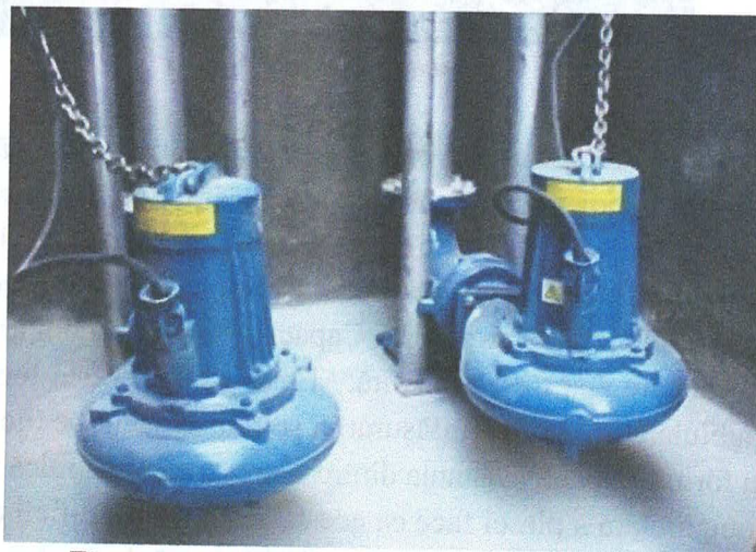
Figura nr. 19. Pompe centrifugale de alimentare
