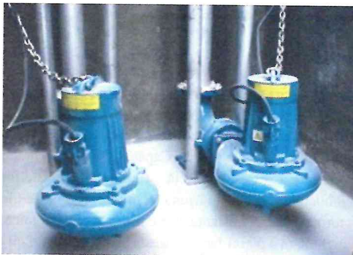
Figura nr. 19. Pompe centrifugale de alimentare
