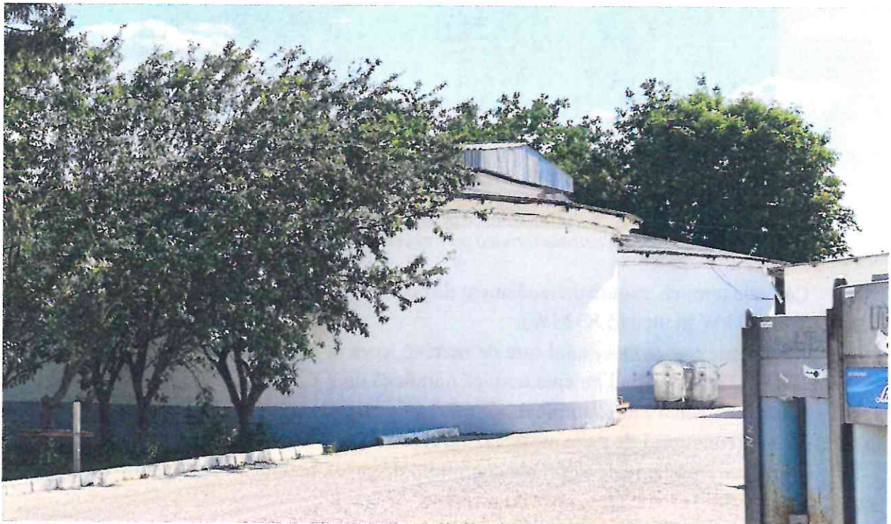
Figura nr. 7. Gospodărie de apă – rezervoare de înmagazinare
