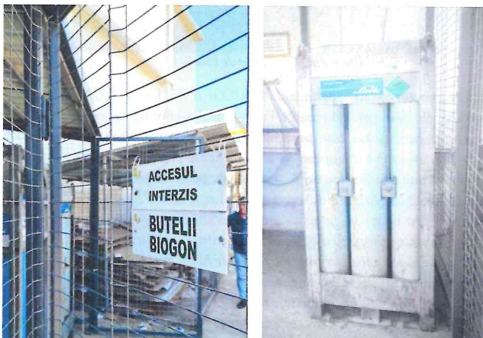
Figura nr. 27. Spațiul de depozitare a buteliilor de BIOGON
