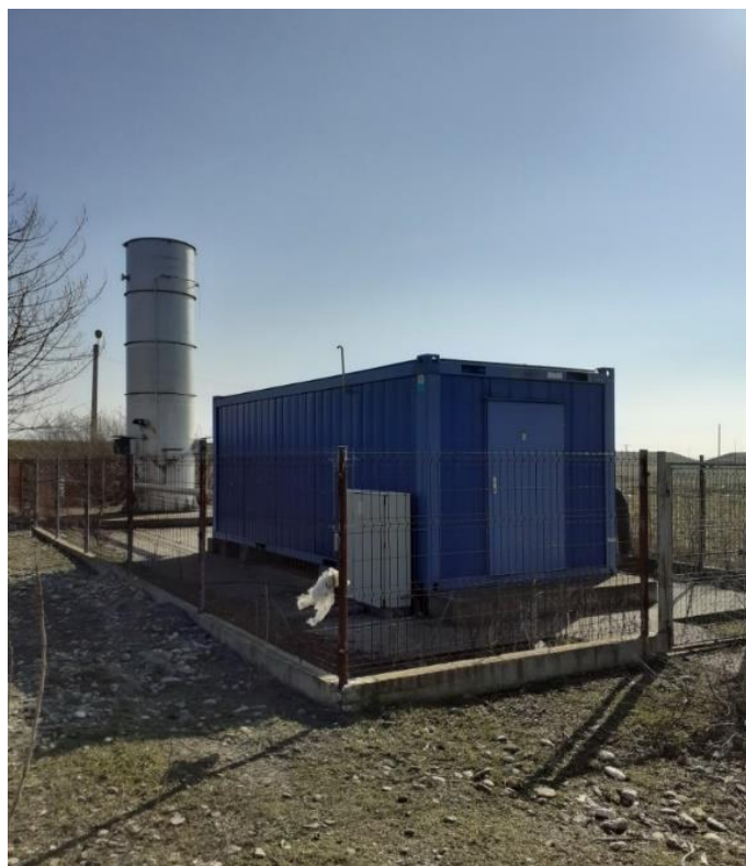
Foto. 6 Stația de ardere biogaz / gaz de depozit
