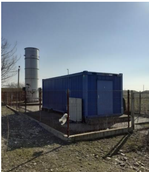
Foto. 18 Stația de ardere biogaz / gaz de depozit
