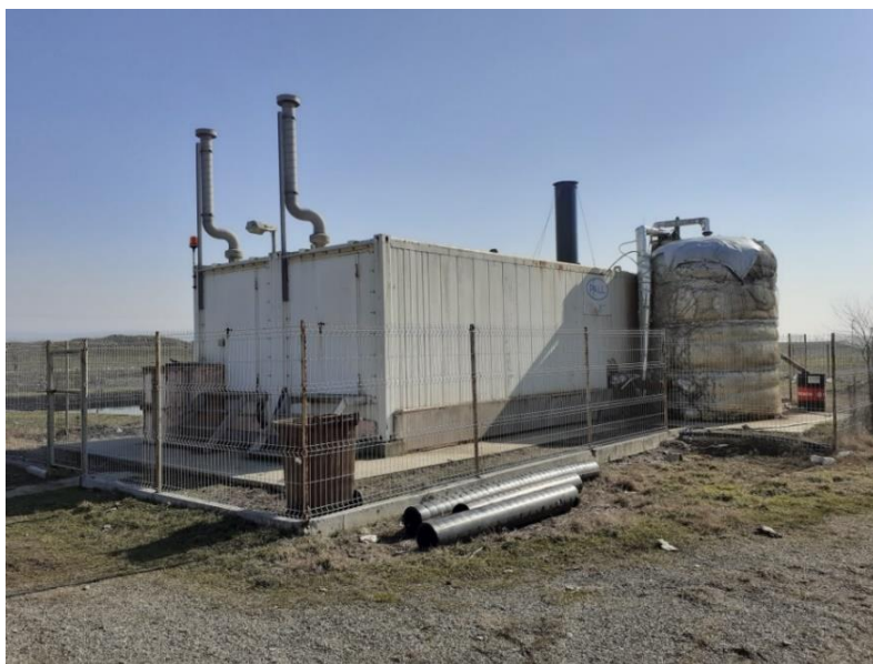
Foto. 17 Stația de epurare
