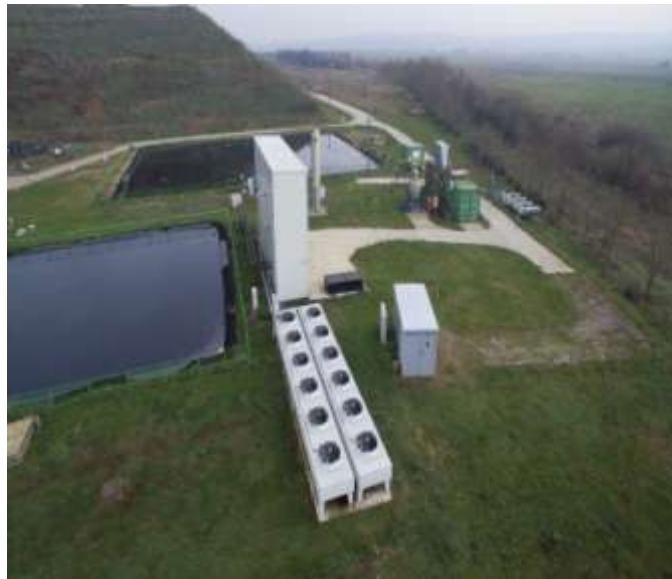
Fig. nr. VII.1.5.1 Instalația pentru valorificarea gazului de depozit și instalația de evaporare de lângă celula I înverzită (incinta SC EcoBihor SRL)
