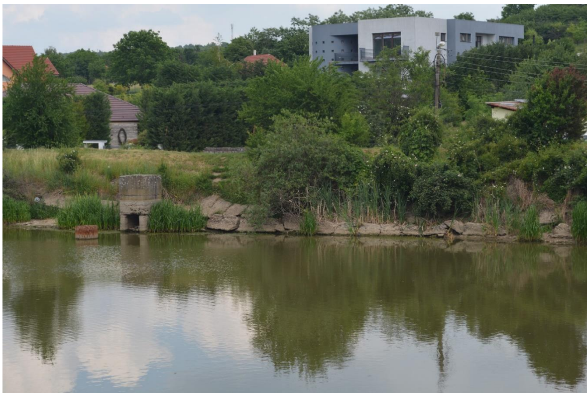
Situația existentă – mască din beton dislocată și degradată
