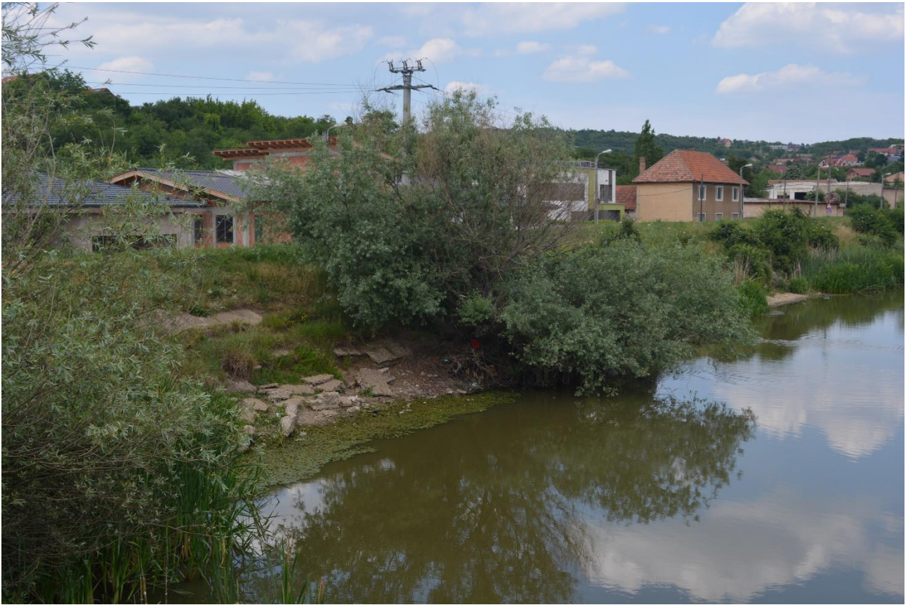
Situația existentă – mască degradată și vegetație pe corpul digului
