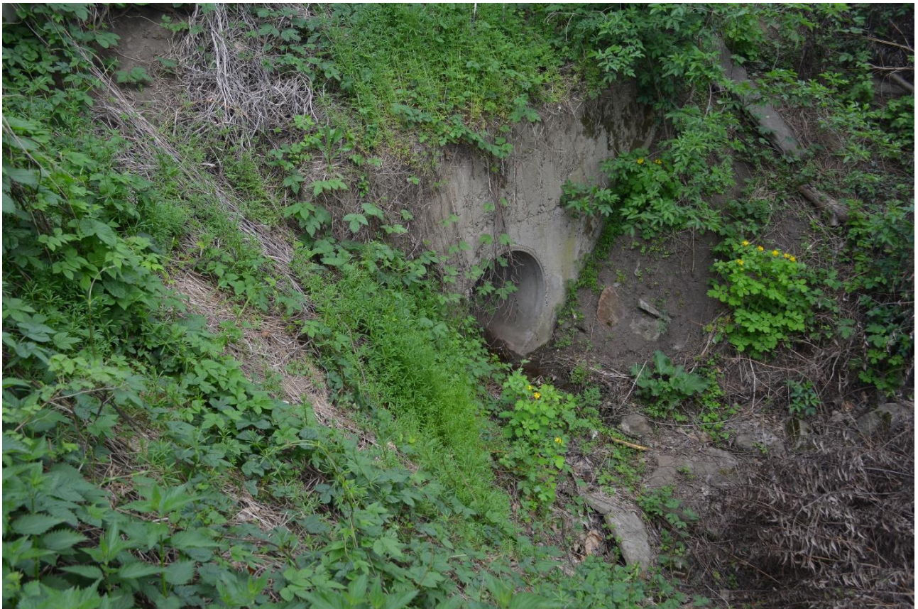
Situația existentă – lipsă disipator de energie
