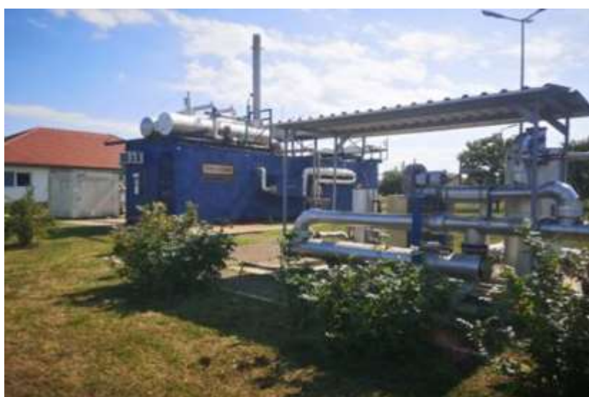
Stația de biogaz din orașul Săcueni (Foto - Consiliul Județean Bihor)
