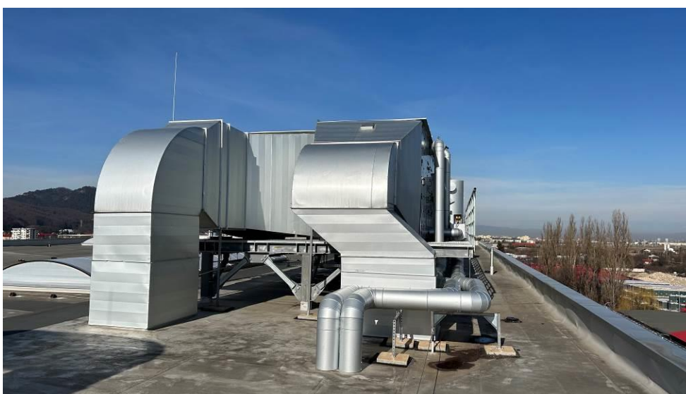
Foto – Sistem ventilație hala îmbuteliere COMBI sticlă
