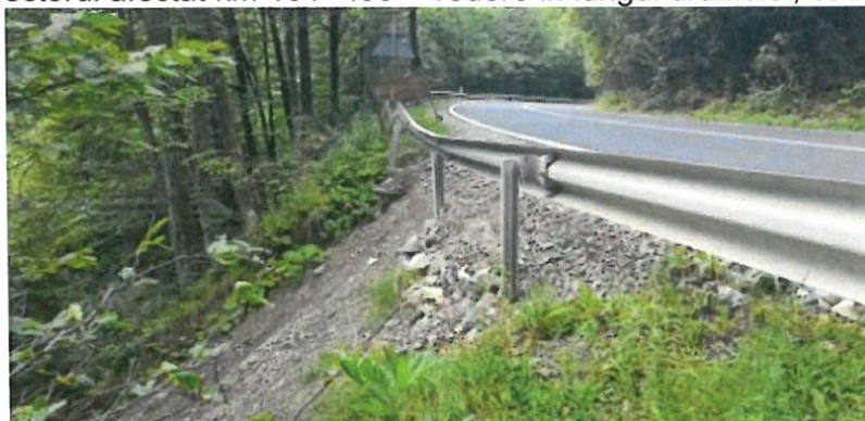
Foto – sectorul afectat km 161+400 – taluz de rambleu afectat de alunecarea terenului
