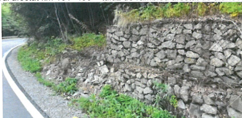
Foto – sectorul afectat km 161+400 – vedere zid de debleu din gabioane deteriorate, deformat, deplasate, cu zone cu plasa rupta si zidaria prabusita
