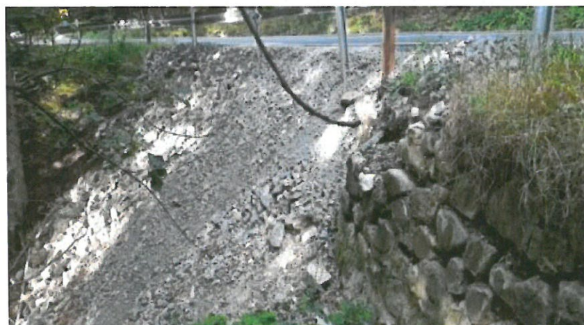
Foto – sectorul km 163+900 – zid de sprijin de rambleu din piatra degradat, lipsa mortarului de legatura (aspect de zidarie uscata), infiltratii si scurgerea materialului din spatele zidului prin rosturi, zona cu prabusirea completa a zidului
