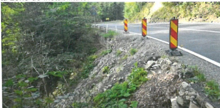
Foto –sfarsitul sectorului km 162+020 – 162+150 – taluz de rambleu instabil
