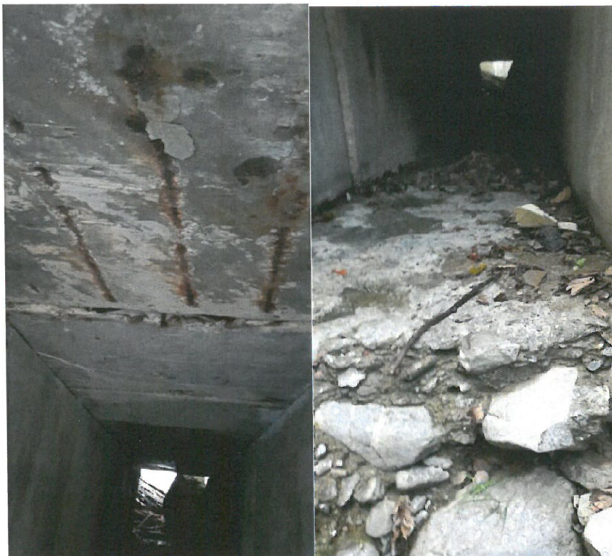
Foto – podet km 162+832 – vedere interior podet, dale prefabricate cu beton exfoliat si armatura aparenta ruginita, elevatie culee crapata, prag degardat la iesirea din podet
