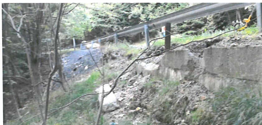
Foto –podet km 163+982 - partea aval, racordarea cu terasamentele distrusa
