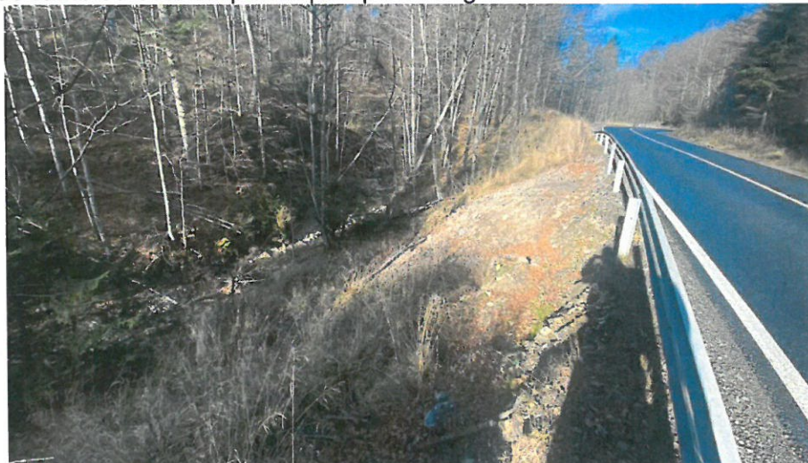
Foto – sectorul afectat km 165+480 – vedere in lungul drumului, catre Brasov
