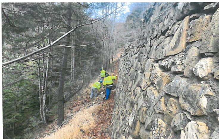
Foto – sectorul km 162+020 – 162+150 – zid de sprijin de rambleu din piatra degradat, Helev. = 4m, lipsa mortarului de legatura (aspect de zidarie uscata), infiltratii si scurgerea materialului din spatele zidului prin rosturi
