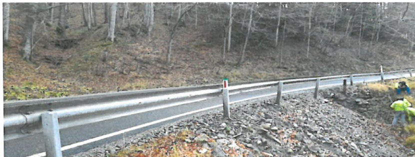
Foto –vedere versant de debleu, torent pe versant ce debuseaza in zona drumului
