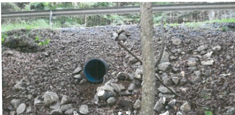
Foto –podet km 163+477 - partea aval, tub corugat pentru prelungirea podetului, resturi ale racordarii aval din zidarie de piatra
