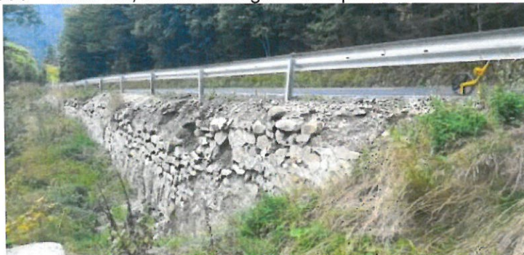
Foto –zid de sprijin de rambleu din piatra degradat, inainte de zona alunecata
