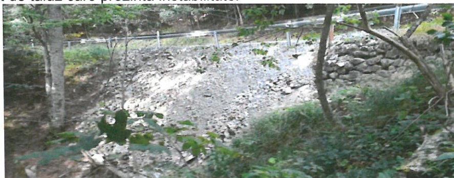
Foto –sfarsitul sectorului km 163+900 –refacerea tronsonului de zid prabusit cu umpluturi instabile
