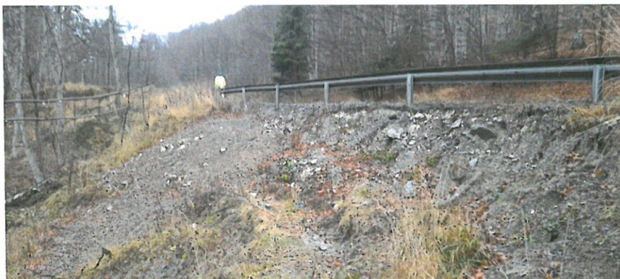
Foto – sectorul afectat km 165+480 – taluz de rambleu si acostament afectate de alunecarea terenului
