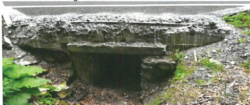
Foto – podet km 163+477 – vedere amonte, grinda de coronament foarte degradata
