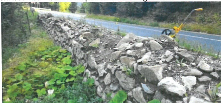
Foto –zidarie de piatra foarte degradata amplasata dupa zona alunecata
