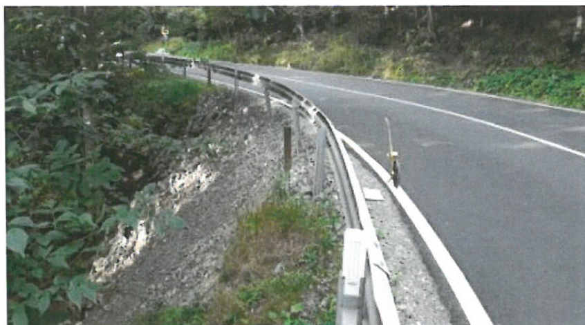
Foto – sectorul afectat km 163+900 – vedere in lungul drumului, catre Brasov
