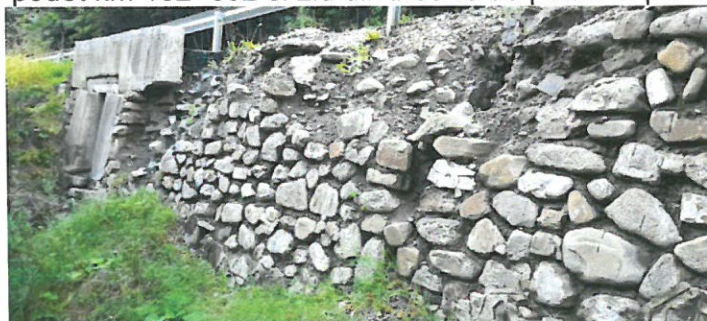
Foto –podet km 162+832 si zid din zidarie de piatra in partea aval, lipsa mortarului de legatura din rosturi, pietre desprinse, zone cu elevatia prabusita
