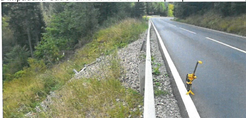
Foto – sectorul afectat km 162+650 – vedere in lungul drumului, catre Brasov
