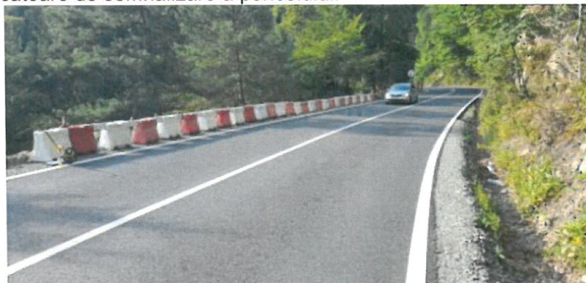
Foto – sectorul afectat km 162+020 – 162+150 – vedere in lungul drumului, catre Brasov
