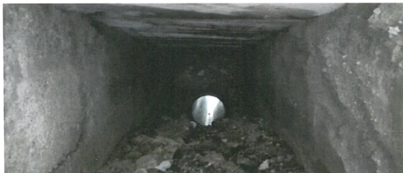
Foto – podet km 163+982 – vedere interior din amonte, beton exfoliat si armatura vizibila si corodata la intrados dale, elevatie culee crapata
