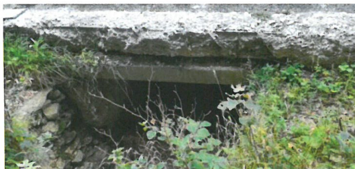
Foto – podet km 163+982 – vedere amonte, camera de cadere din zidarie de piatra si grinda de coronament din beton armat foarte degradate
