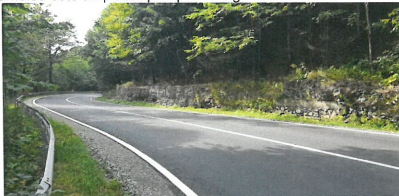
Foto – sectorul afectat km 161+400 – vedere in lungul drumului, catre Brasov
