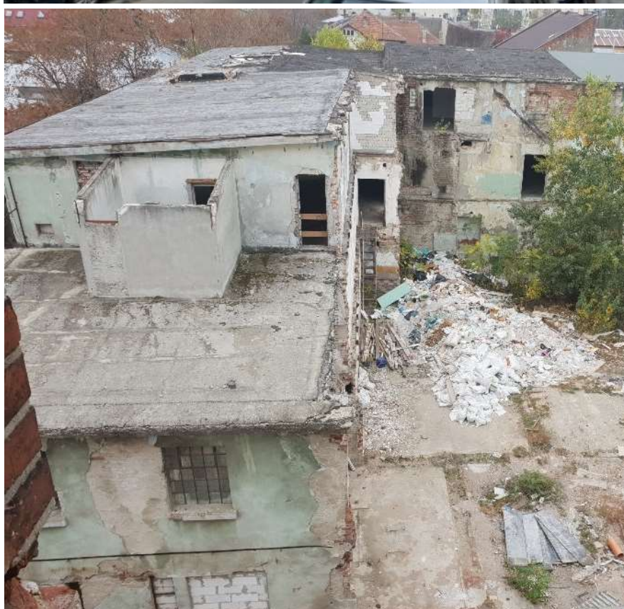
- vedere din curtea interioara Corpul C6 partial prabusit
