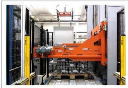
Figură 16: platformă în timpul fazei de descărcare
