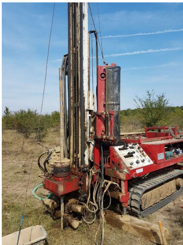
- Instalatie de foraj
