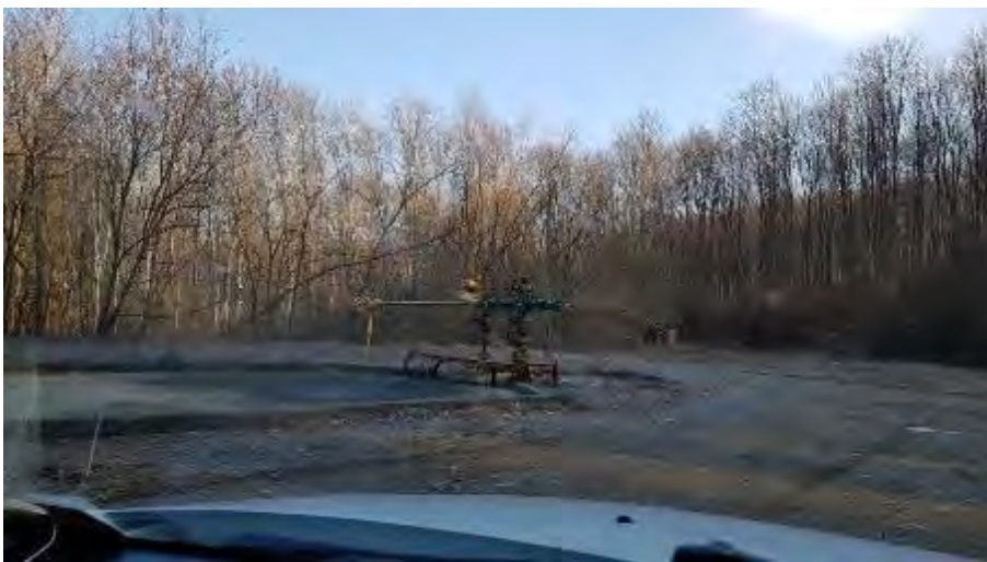
Sonda de gaz în zona de lucru
