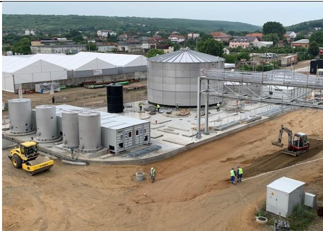
Fotografie nr. 1 - Stație de epurare
