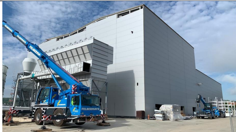
Fotografie nr. 2 - Secție măcinare
