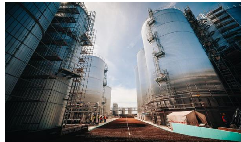
Fotografie nr. 5 - Rezervoare hidroliză
