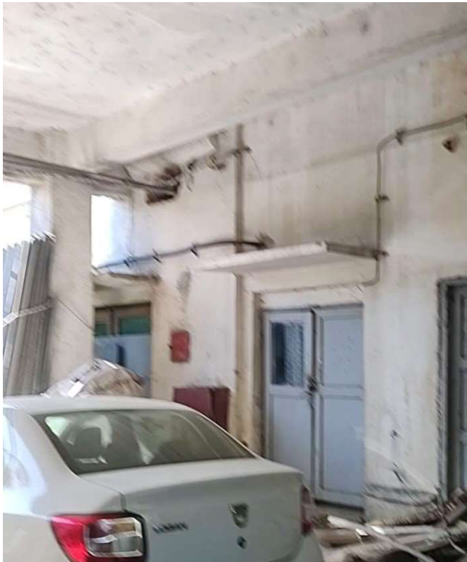
C23- Centrala termica
