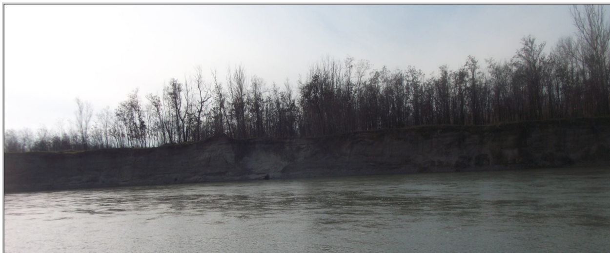
Eroziune activa a malului drept
