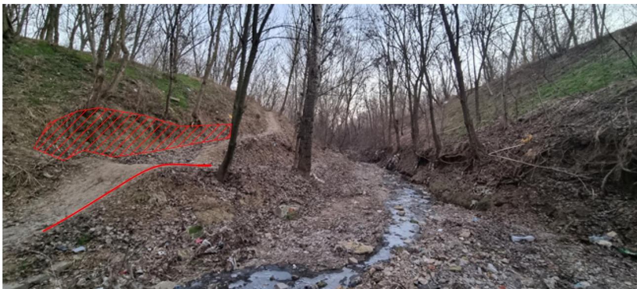
Fig. 48 Degradarea solului cauzata de calcare, fenomene de batire, colmatare si pierdere a materiri din sol.
