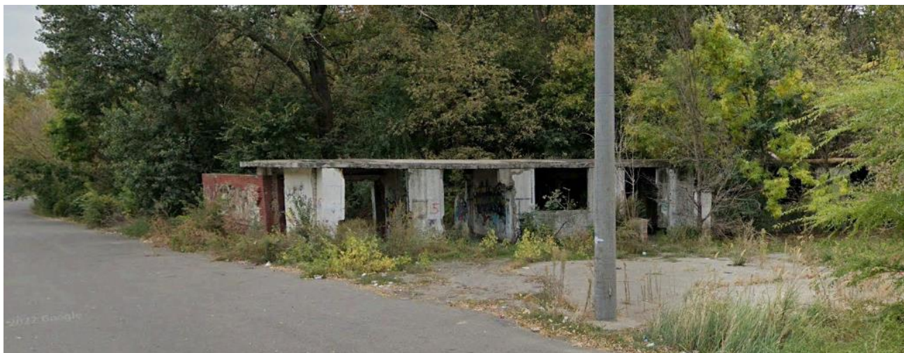
Fig. 53 Constructie degradata, neintabulata propusa pentru demolare.
