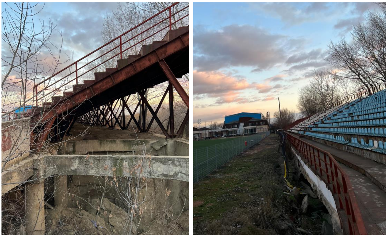
Fig. 36 Foto situație amplasament – zone de instabilitate ale terenului identificate Stânga – exteriorul tribunei / dreapta interiorul Stadionului Siderurgistul
