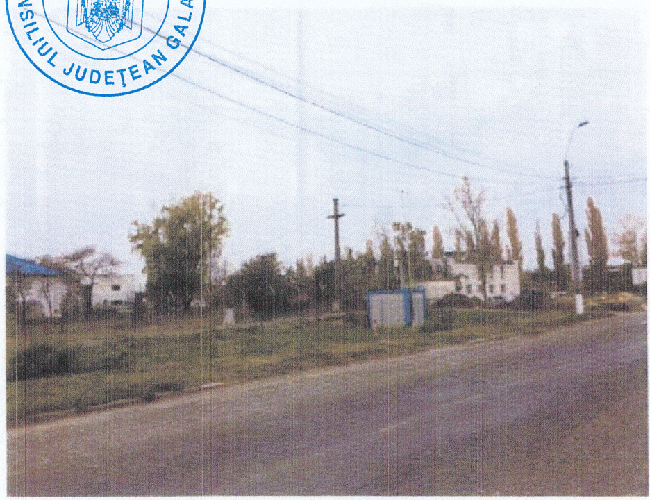
Figura nr. 2-13. Stația de tip industrial GL 5, amplasată în municipiul Tecuci, str. 1 Decembrie, nr. 146B
