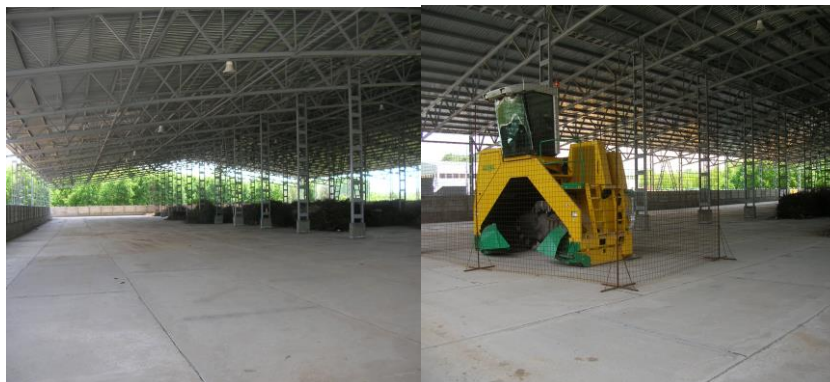
Stația de compostare Galați
