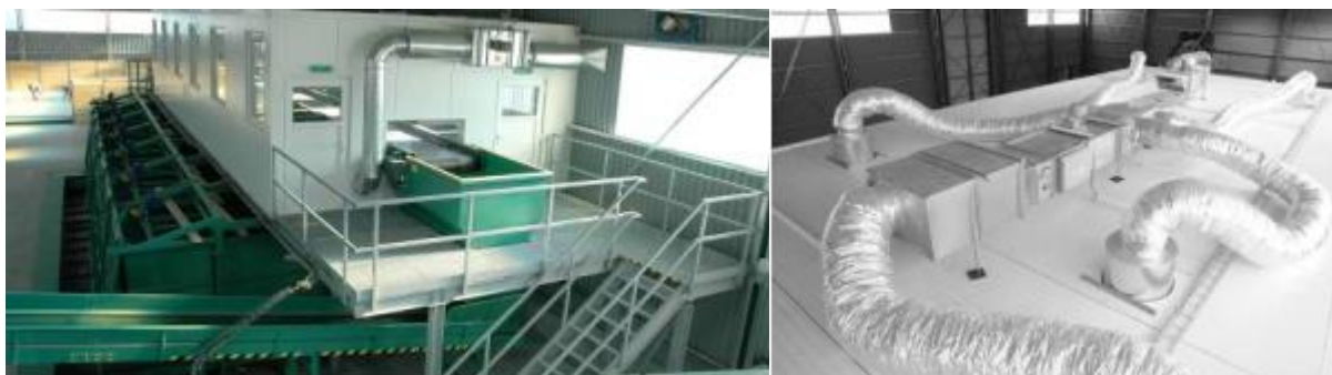
Figura 2.9. Cabina de sortare TEHNOBALT TBSorting dotată cu sistem de aer condiționat și de ventilare și cu instalație de absorbție a aerului viciat
