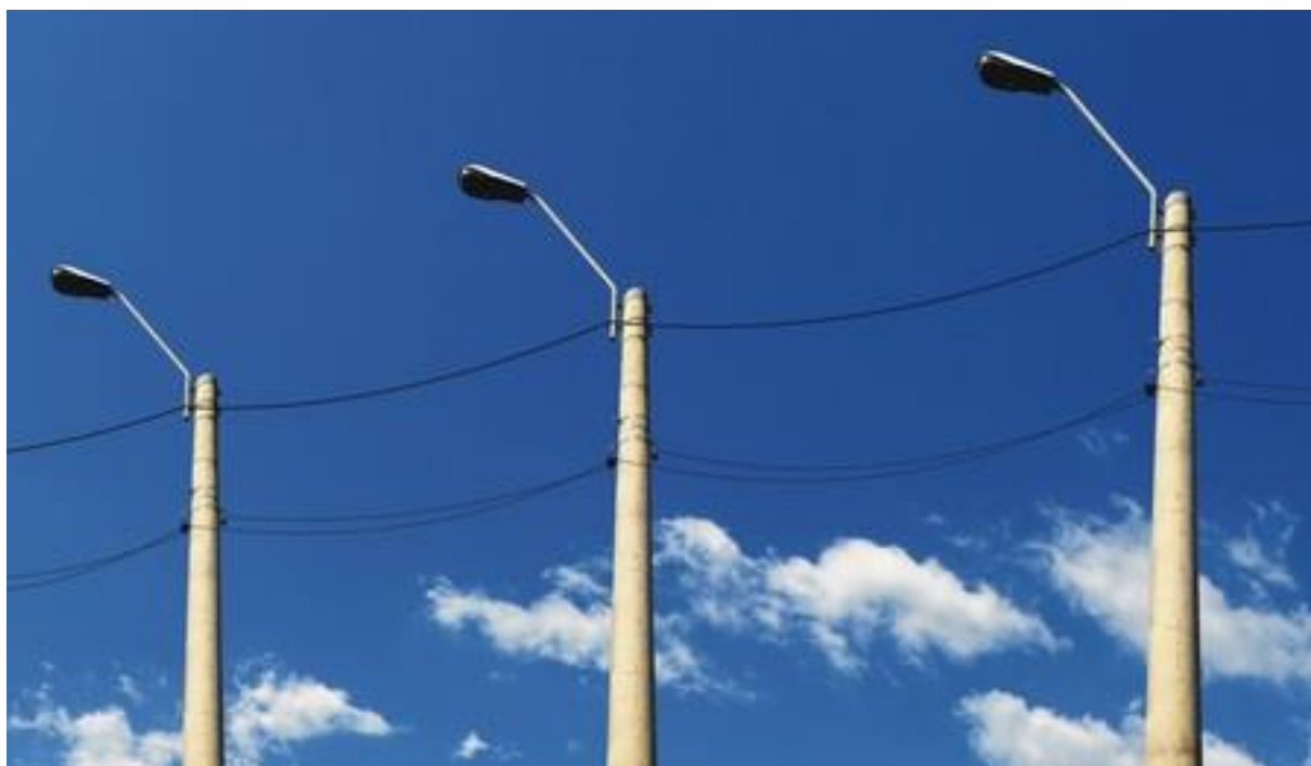
Figura 3 Rețea electrică pe stâlpi
