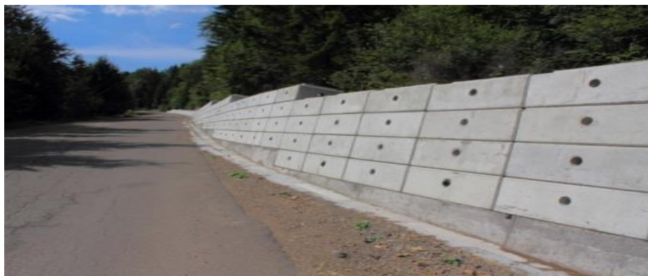
Fig.V.1.4.1.3.Parapet din beton lângă DN 2D, barieră absolută pentru lup
