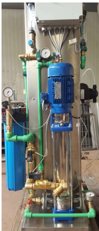
Foto - Pompa dozatoare cu osmoza
