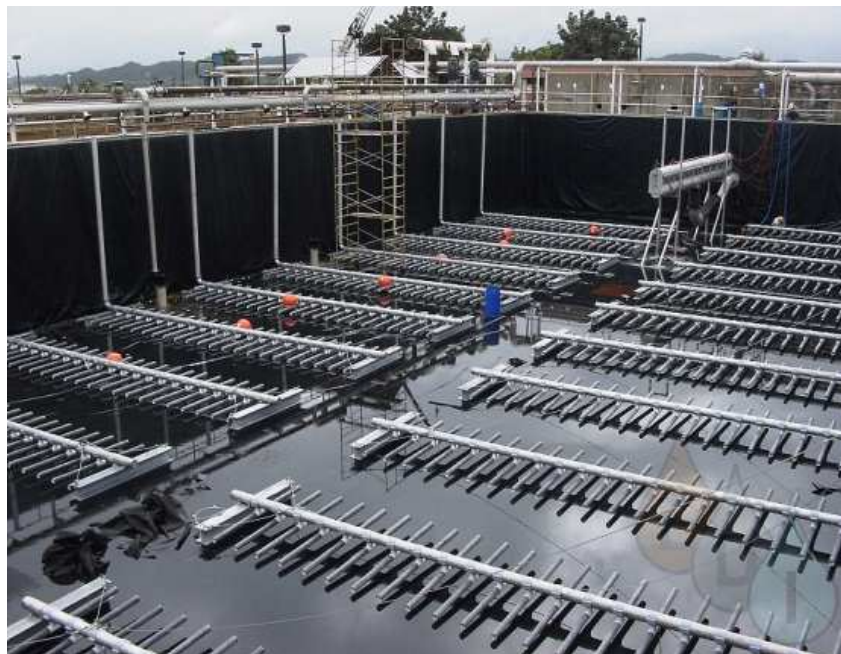
Figura nr. 8. Exemplu de rampe de aerare
