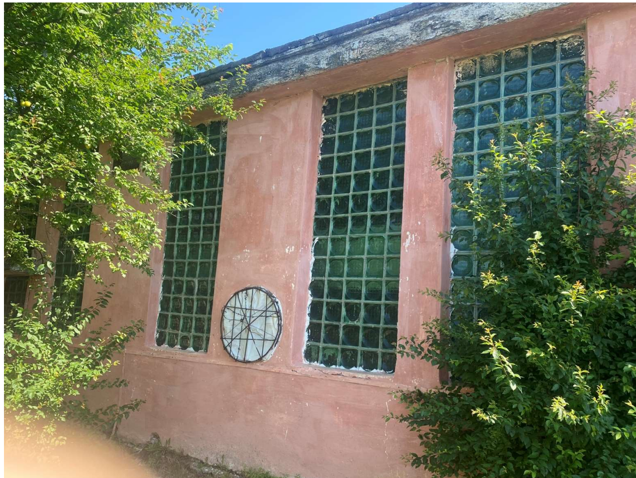
Figura nr. 2: Stația de repompare SRPA 2
