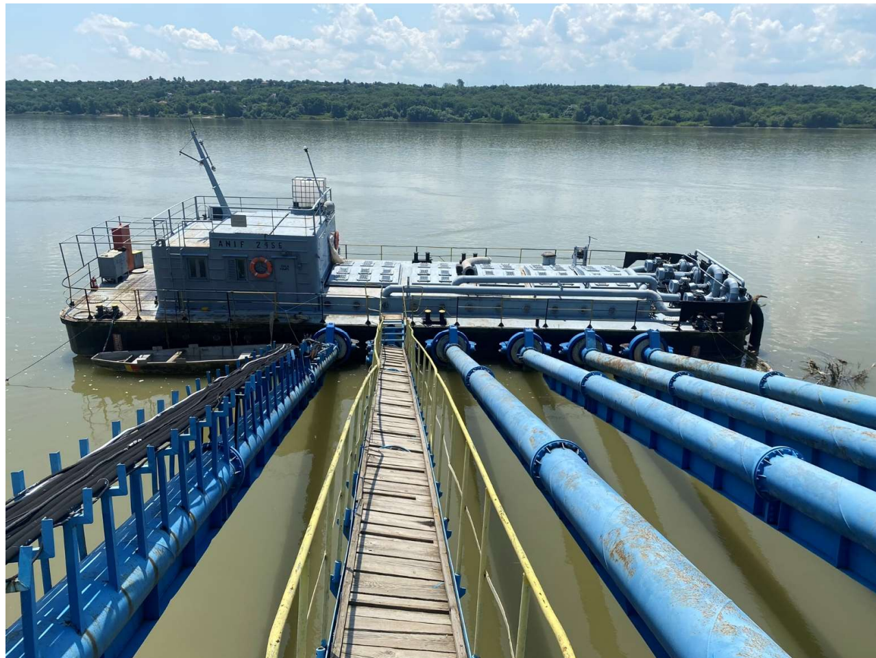
Figura nr. 1: Stația de pompare plutitoare SPA Salcia
