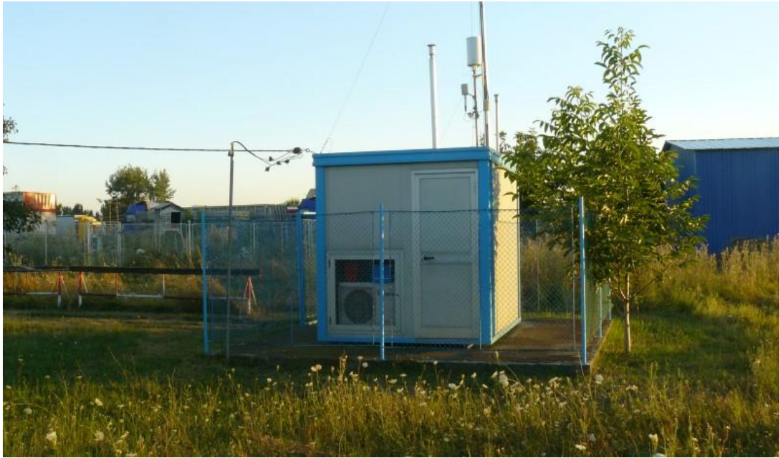
Stația de monitorizare a influenței industriale MS – 2
