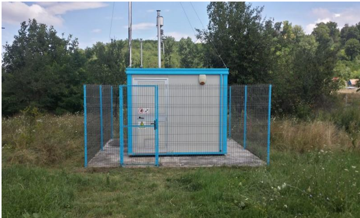
Stația de monitorizare a influenței industriale MS – 3
