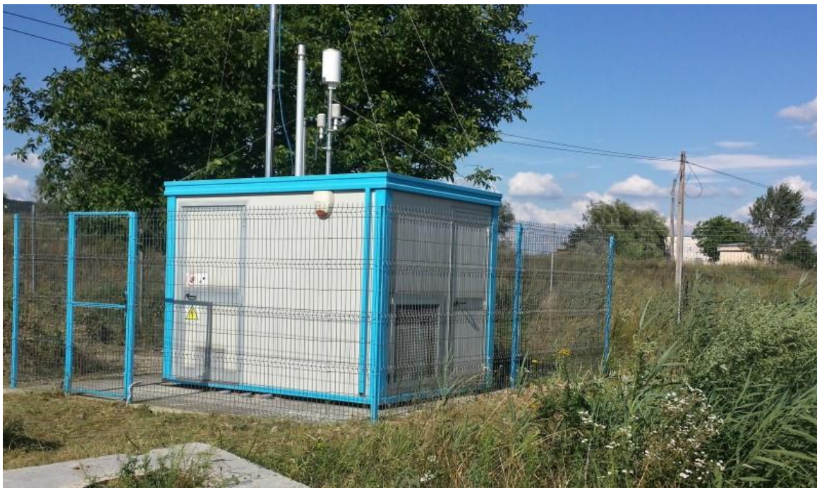
Stația de monitorizare a influenței industriale MS – 4
