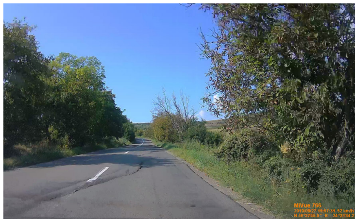
❖ Tasări și crăpături ale carosabilului vizibile pe DJ 151B în zona km 12+580
