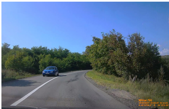
❖ Tasări și crăpături ale carosabilului existent pe DJ 151B în zona km 11+560
