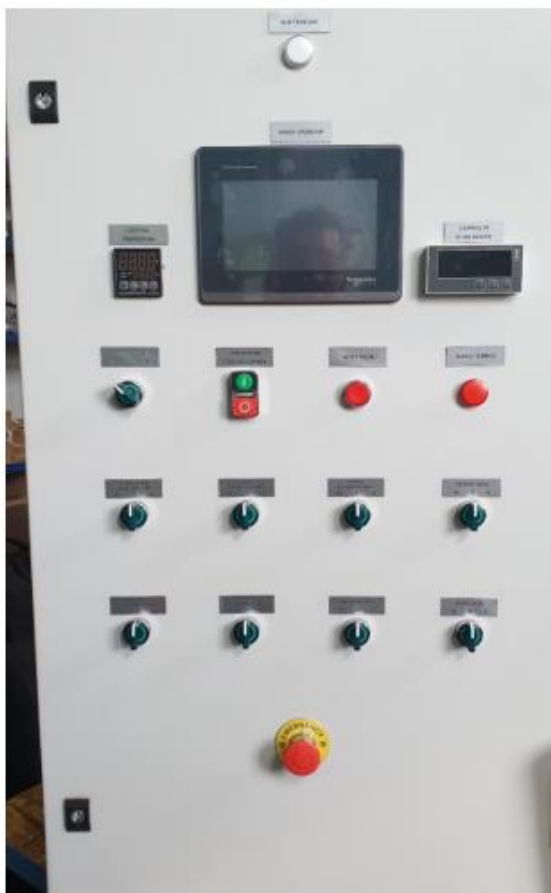
Figura 12 Detaliu tablou de comandă și automatizare instalație de spălare și tratare ape uzate
