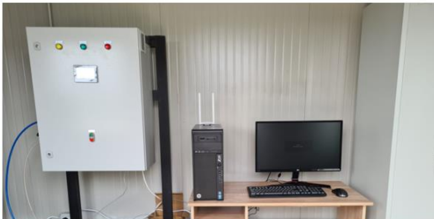
Figura 15 Sistem de monitorizare continuă a emisiilor
