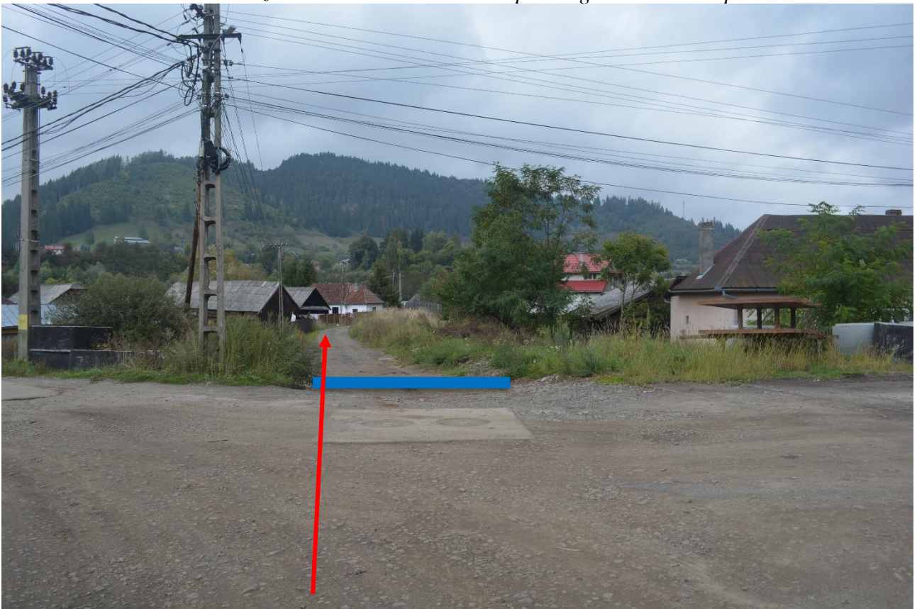
Traversare cu conducta de aductiune ingropat peste nivelul tubului de canaliare pluviala aferent drumului public
