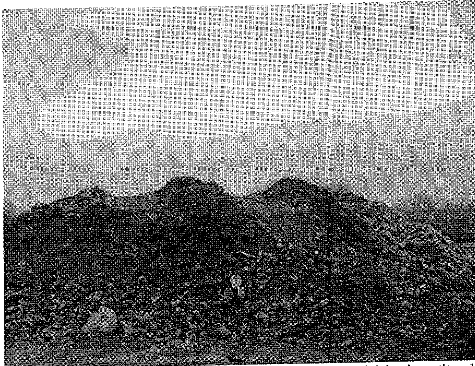
La est, se găsește teren folosit ca spațiu de depozitare a materialelor investitorului.
