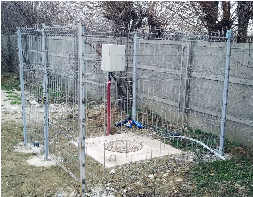
Imagine 2 – Stație de pompare apă uzată menajeră (existentă) – Stoenești
