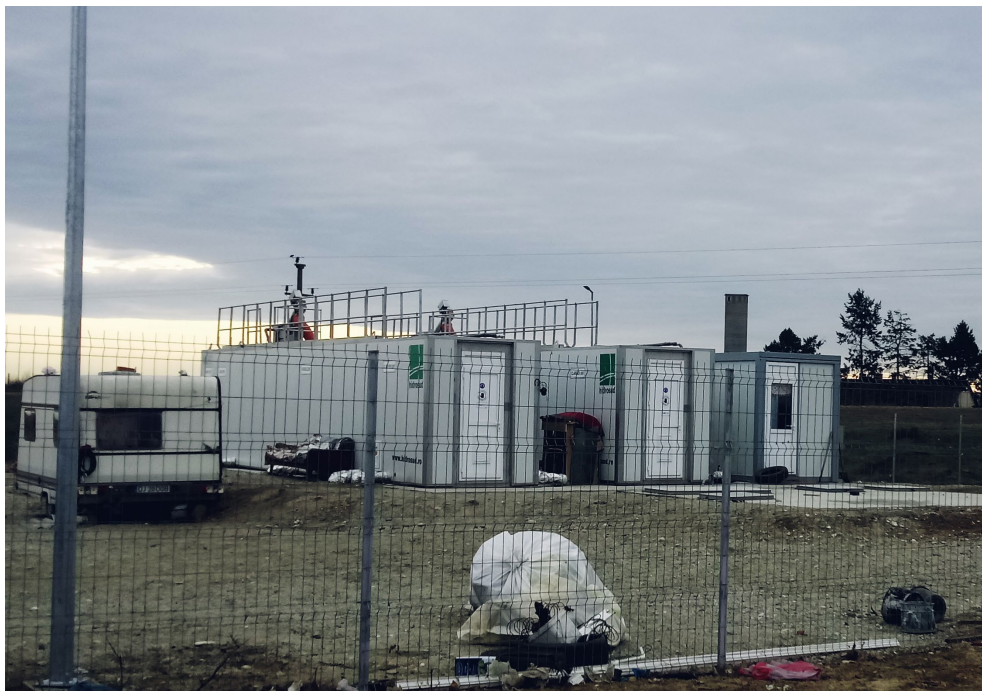
Imagine 1 – Stație de epurare (existentă) – Stoenеști
