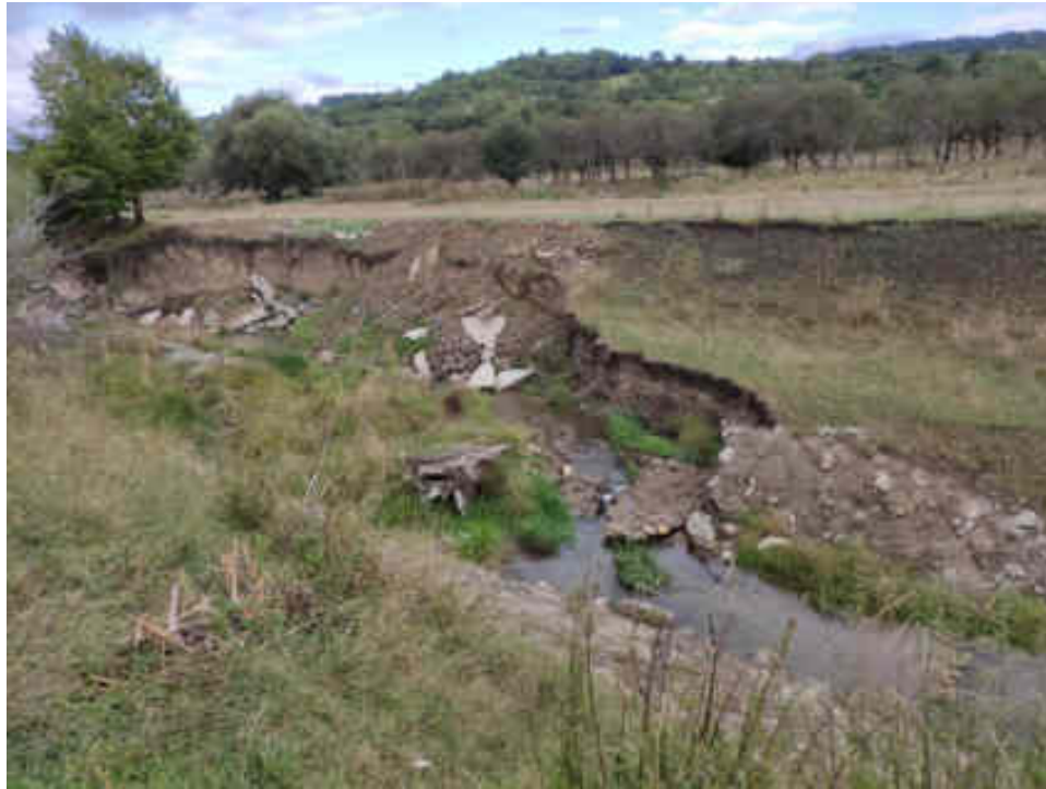
Tronson afectat de eroziune puternica, activa
