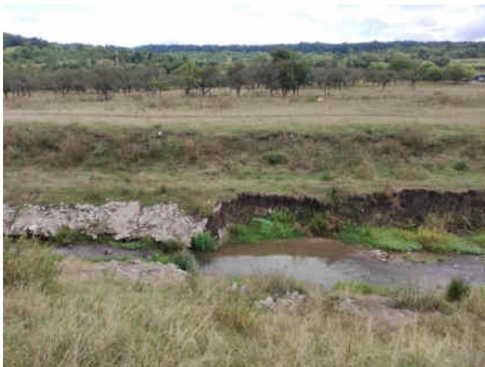
P. Cisnadie in zona adiacenta lac Cisnadie – lucrari de amenajare a albiei degradate, eroziuni
