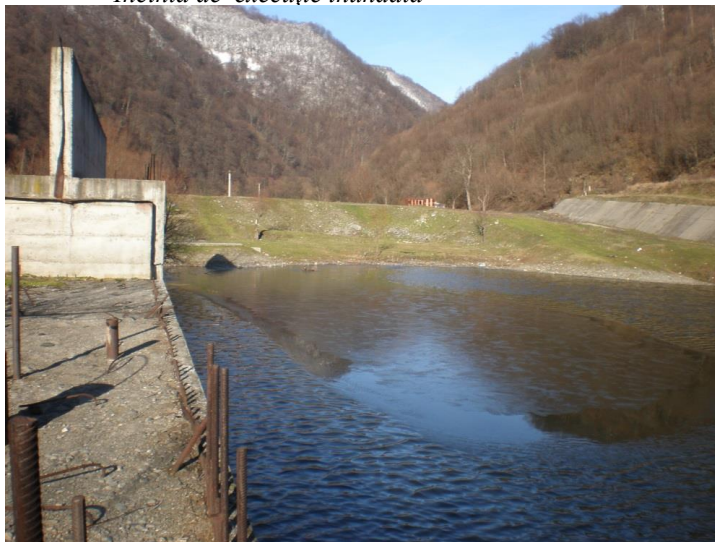
Incinta de execuție inundată
