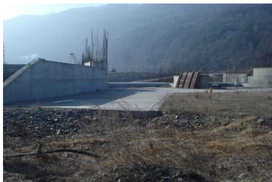
Zid amonte mal stâng
