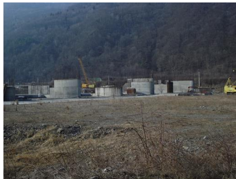
Vedere nod hidrotehnic din amonte
