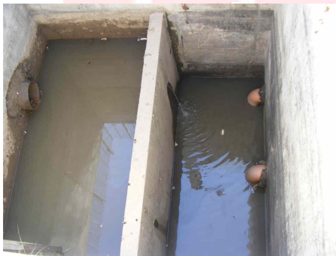
- decantor (separator) apă pluvială
