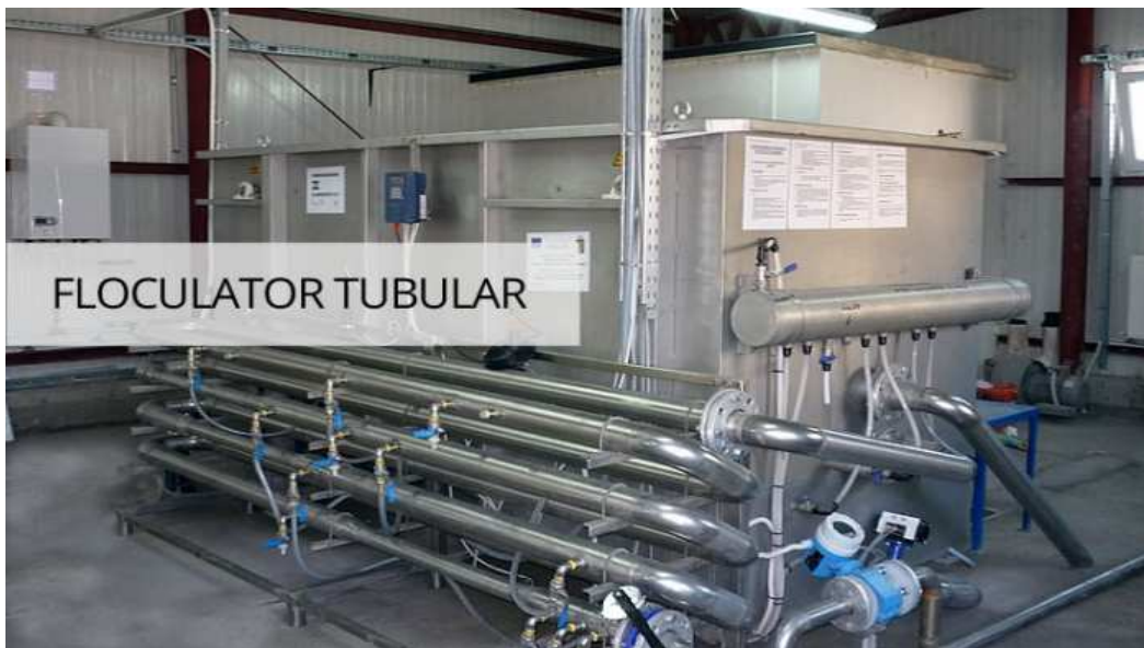
Figură 12: flocculator tubular
