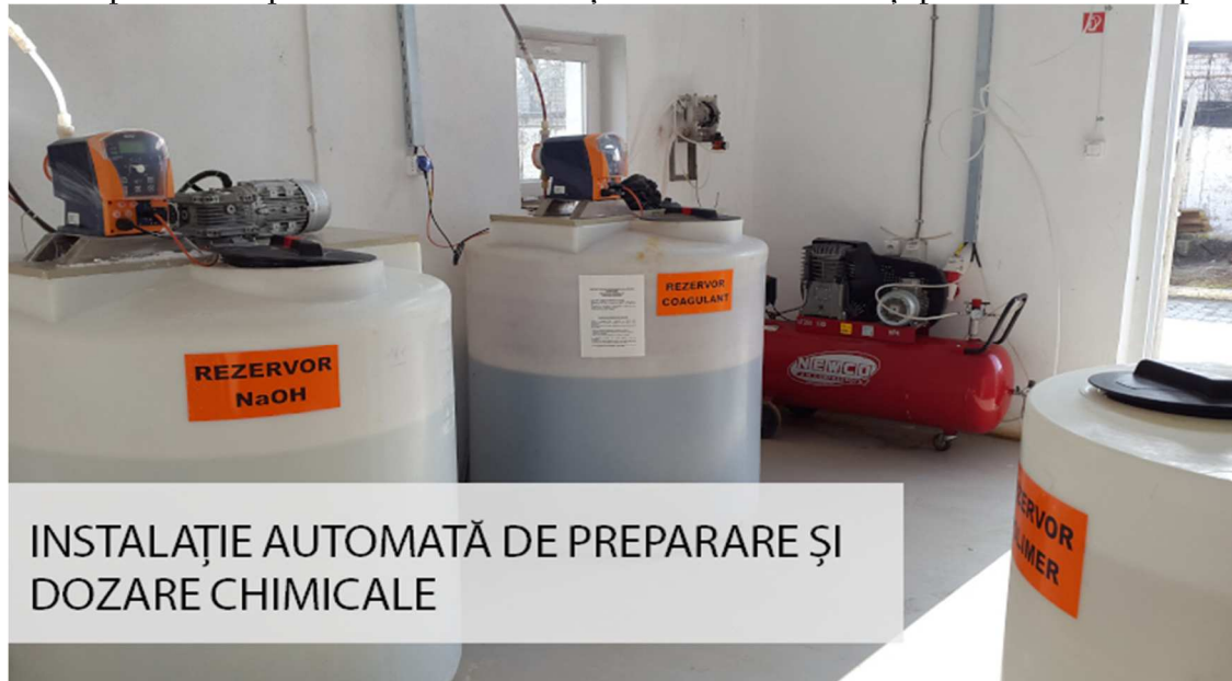
Figură 13: instalație automată de preparare și dozare chimicale
