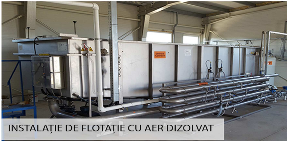
Figură 11: instalație de flotație cu aer dizolvat
