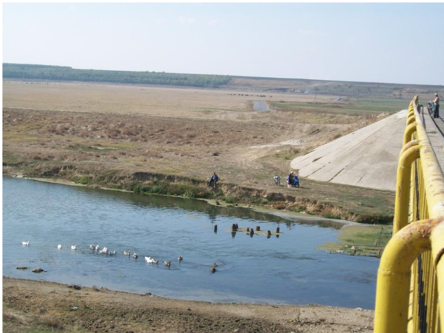
Malul drept erodat imediat aval de pod
