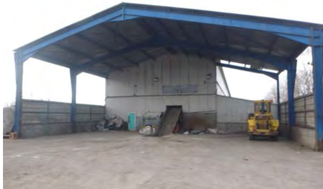
Platforma pentru receptia deseurilor
