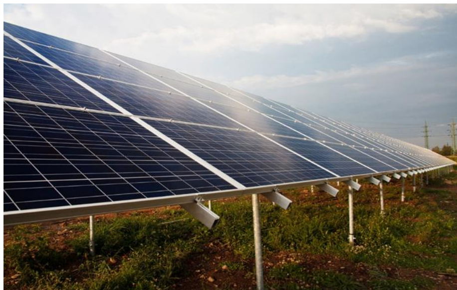
Fig. 3 – aspect panou fotovoltaic
