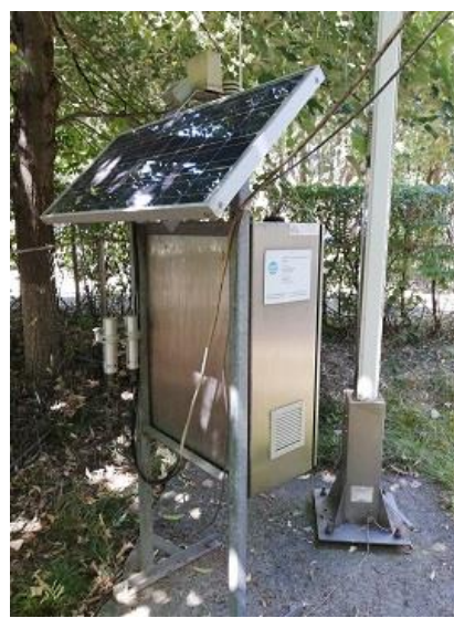
Stație automată de doză gama
