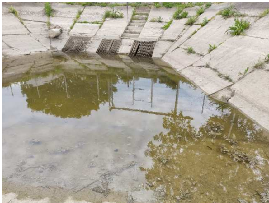
Canalul de aductiune CA1C Foto 22. Bazinul de aspiratie al statiei de pompare SPP2 Pereu deteriorat si napadit de vegetatie ierboasa
