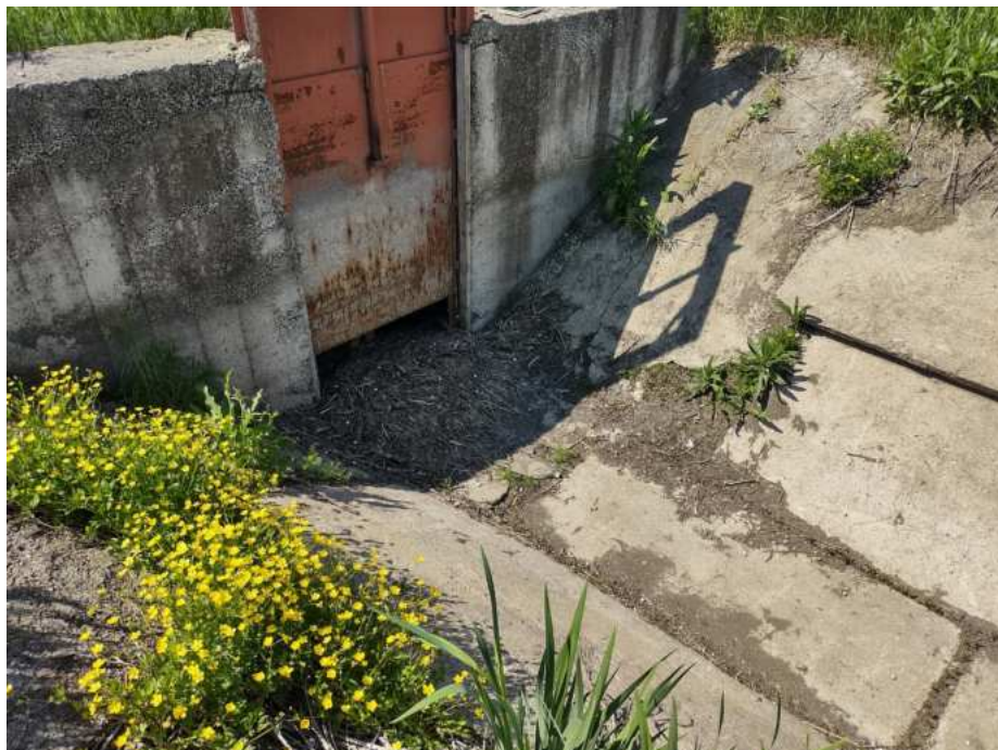
Canalul de aductiune CA1C Foto 16. Stavilar degradat pe canal. Peruu deteriorat si napadit de vegetatie ierboasa in zona stavilarului
