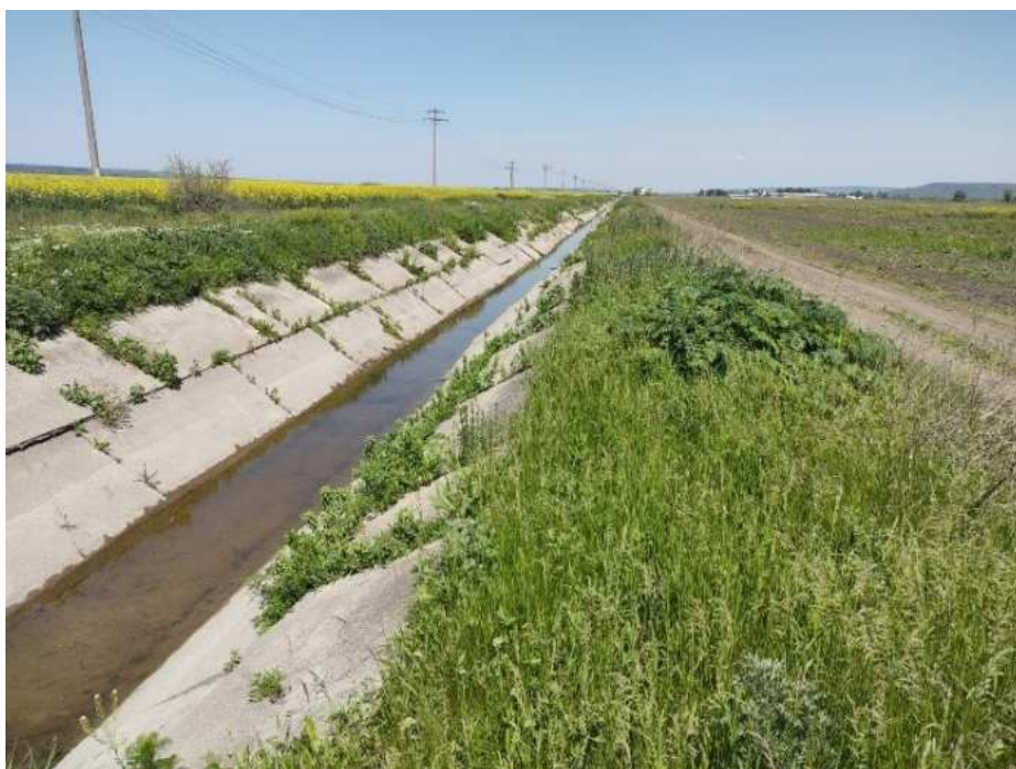
Canalul de aductiune CA1C Foto 17. Peruu invadat de vegetatie
