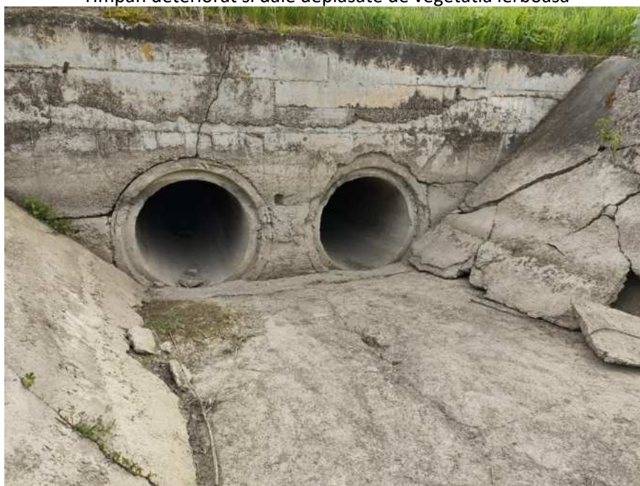
Canalul de aductiune CA1C Foto 25. Podet tubular cu 2 fire. Timpan si perez canal deteriorate
