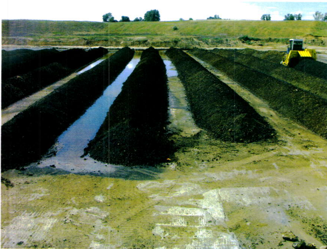
Foto : Platforma bioremediere
